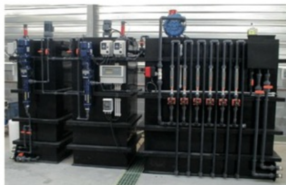
STATION DE TRAITEMENT D'EAU DE REJET
